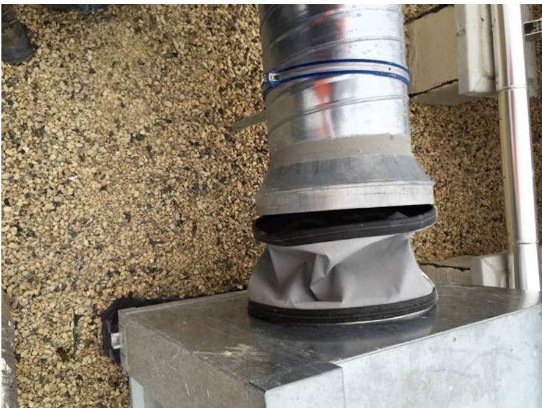
▲ Bild 6 • Leckagen sind oft auch an Verbindungen unterschiedlicher Luftleitungskomponenten zu finden, die nicht sorgfältig und fachgerecht ausgeführt wurden.
