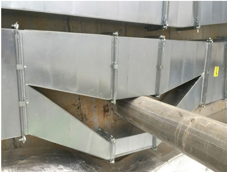
◀ Bild 7 • Zu den Ursachen für Undichtheiten gehören auch komplizierte Aufmaßbauteile, die auf der Baustelle gefertigt und oft unter beengten Platzverhältnissen mit dem restlichen Luftleitungssystem verbunden werden müssen.
